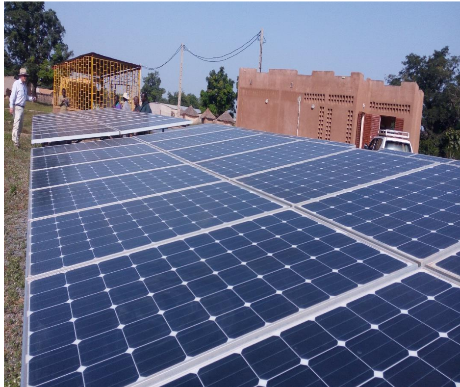
Commune Rurale de Bancoumana (2015) : Centrale Solaire financée par la KFW – Etat Malien – l'Op. ACCESS
