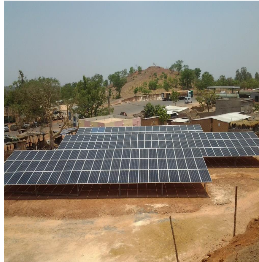
Commune Rurale de Kouramalé (2015) : Centrale Solaire financée par la KFW – Etat Malien – l'Op. SPE
